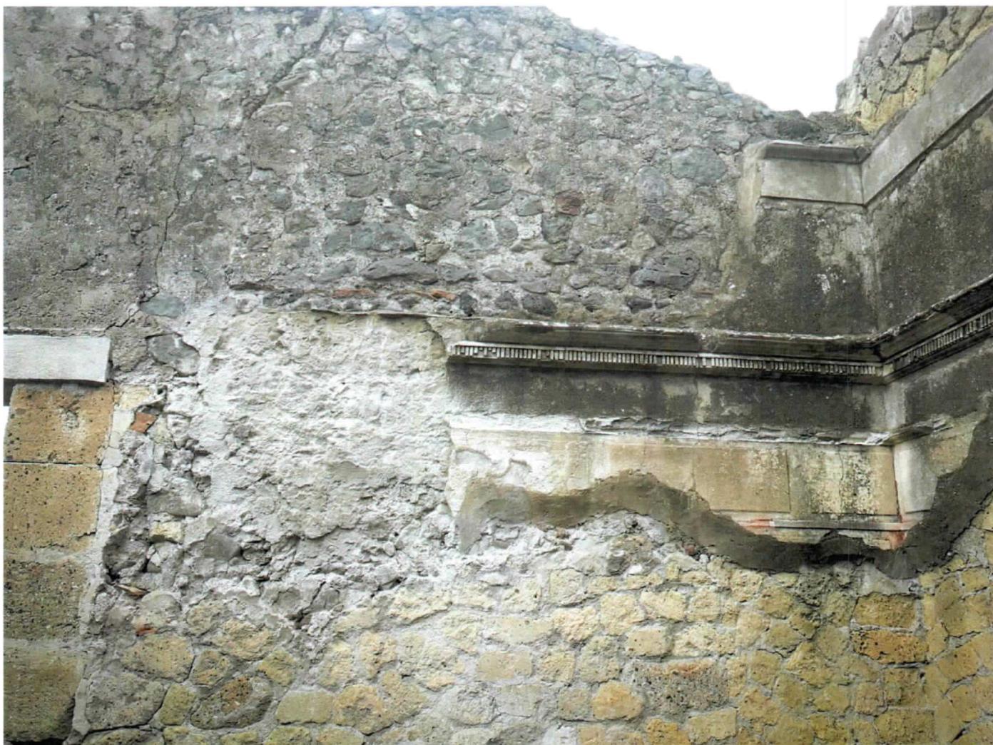
Figura 1 CASA DELLA FULLONICA, AMBIENTE 9, PARETE OVEST, DOPO IL CROLLO DEL 5 NOVEMBRE
